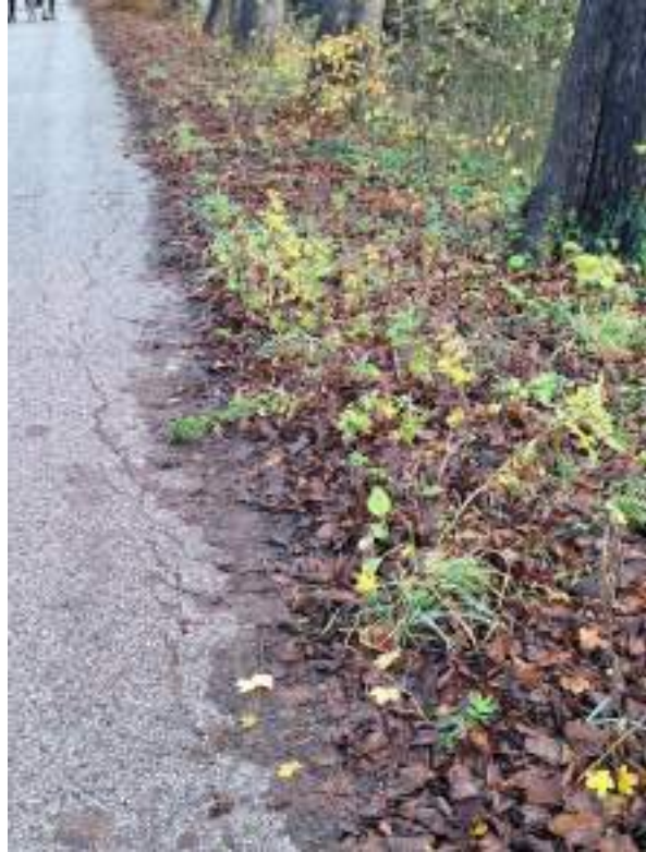
Scheuren in asfalt door afschuiven berm?
